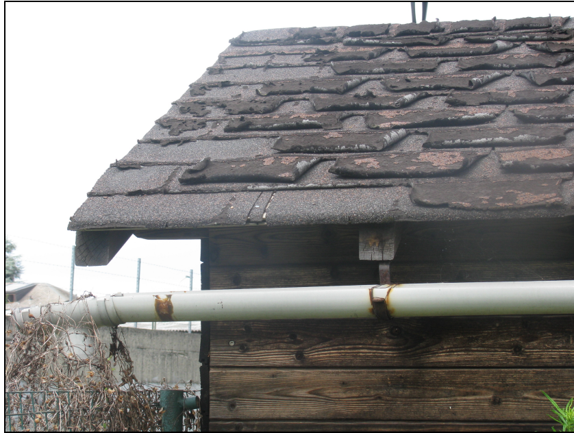
Manto di copertura ammalorato
