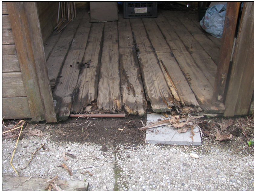
Assito di basamento ammalorato
